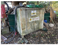
cuve et pompe
